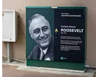
Armoires de rue
